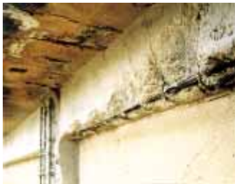
塩害・中性化による鉄筋の腐食
