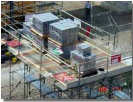
生コン車への投入ステージ
